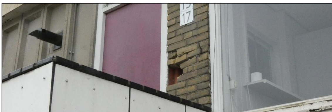
Figuur 14: In de bebouwing grenzend aan het plangebied, Nijverheidsweg 15, zijn op meerdere plekken gaten in de muur aanwezig. Deze ruimtes kunnen door gebouwbewonende vleermuissoorten als verblijfplaats gebruikt worden.
