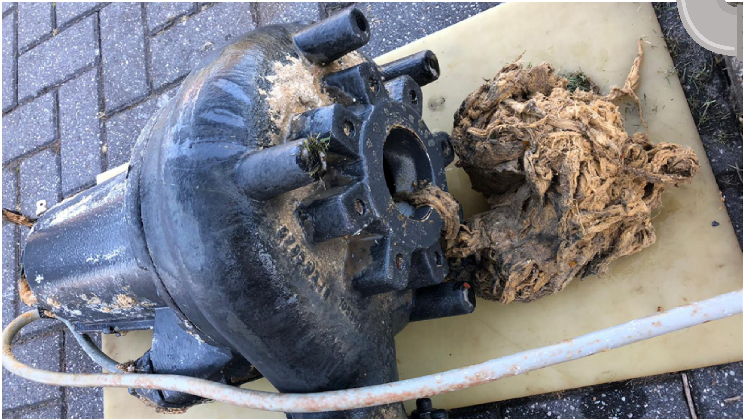
Een verstopping van een rioolgemaal of van huisaansluiting is vervelend. Verstoppingen ontstaan door vaak door zaken, die in het riool terechtkomen, maar er eigenlijk niet in horen, zoals bijvoorbeeld doekjes, vet en zeepresten. Let in elk geval goed op je eigen lozingsgedrag.
